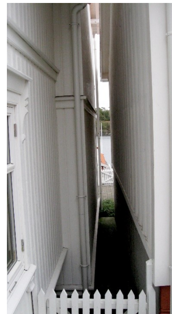
FIGUR 17: VED KORT AVSTAND MELLOM BYGG OG VINDUER I MOTSTÅENDE BYGNINGSFASADER VIL EN BRANN RASKT KUNNE SPRE SEG FRA ET HUS TIL NESTE. BILDET ER FRA LANGESUND SENTRUM, MEN ER REPRESENTATIVT FOR MANGE OMRÅDER MED TETT TREHUSBEBYGGELSE.
