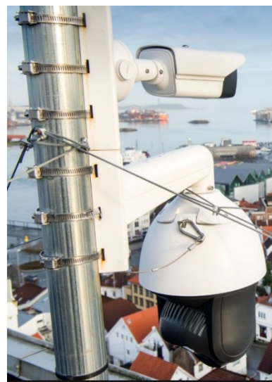
FIGUR 18 STASJONÆRT VARMESØKENDE KAMERA FOR DETEKSJON AV UTVENDIGE BRANNER (UKJENT OPPHAV)
