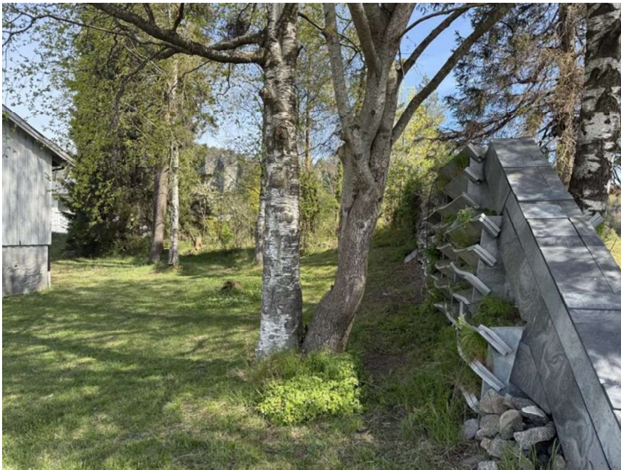
Figur 3-5. Støyskjerm i øst, bildet er tatt fra sør mot nordøst. Bak i bildet ligger skogholtet.
