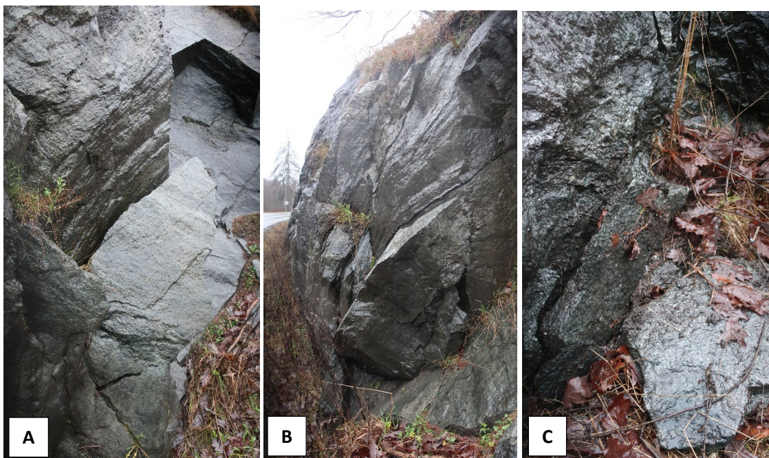
Figur 14: Observert blokknedfall (A), avløst blokk (B) og avskalling langs foliasjonsplanet (C) i nordlig del av bergskjæringen.
