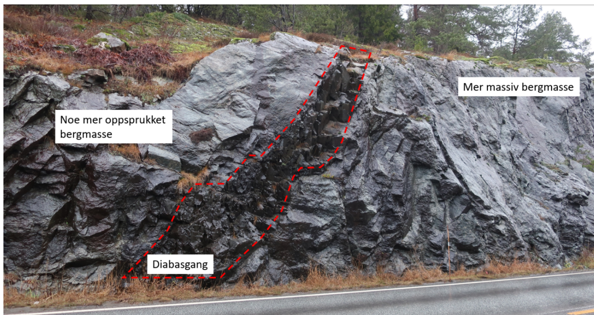
Figur 13: Observert oppsprekingszone i ca. midt i eksisterende bergskjæring, markert med stiptet rødt polygon. Sonen antas å være en diabasgang.
