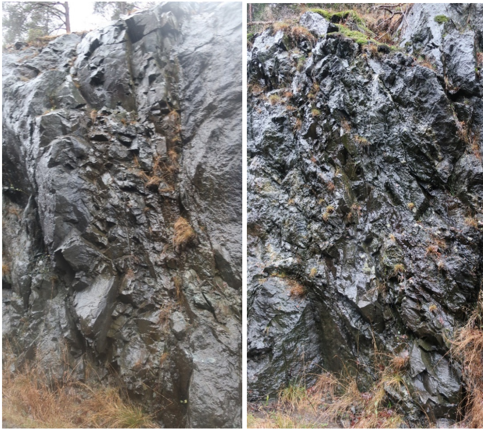
Figur 29: Observerte oppsprekkingssoner på ca. 1 – 2 m, bestående av diabas.
