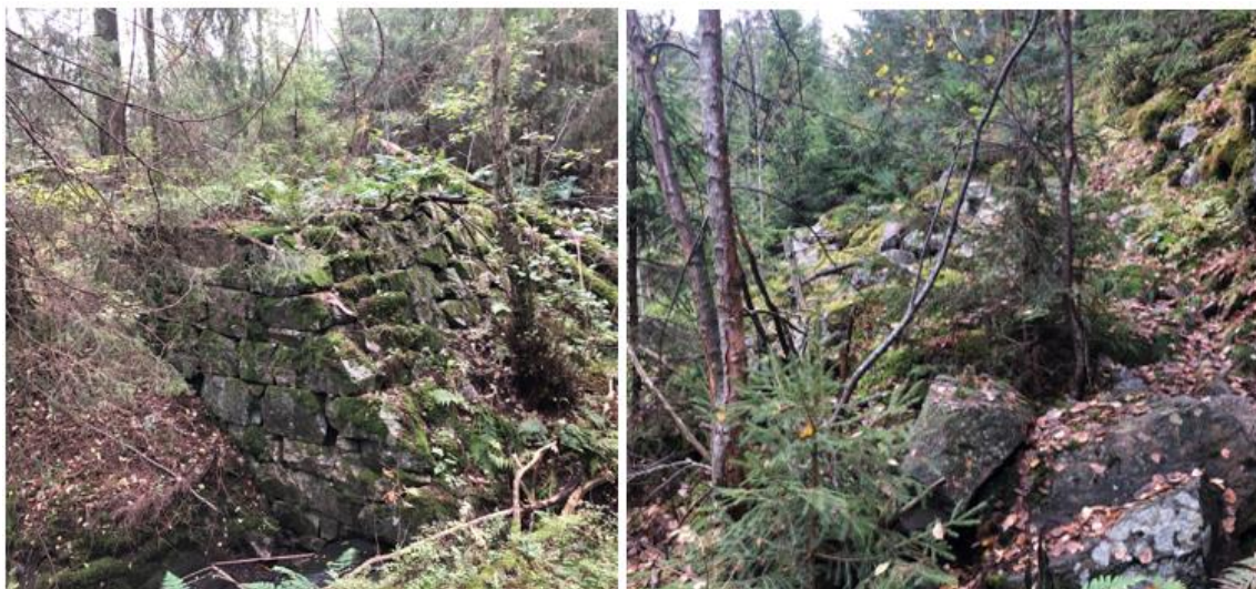
Figur 8 Brofundament for togbanetrase for malmtransport (Id 129892). Skiltet lokalitet. Til høyre typisk dagbrudd/skjerp der bruddmasser ligger i nedkant.
